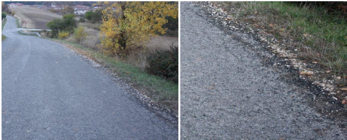
Capa de rodadura desgastado, con gravilla suelta
